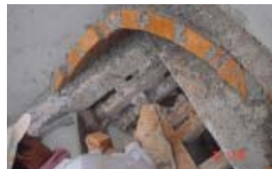
Foto 37. Arco inclinado y apoyado en el anterior.
